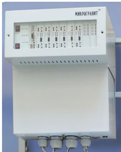
Рис 1.2 Встановлені модулі КП/ПК «Граніт-Мікро»
