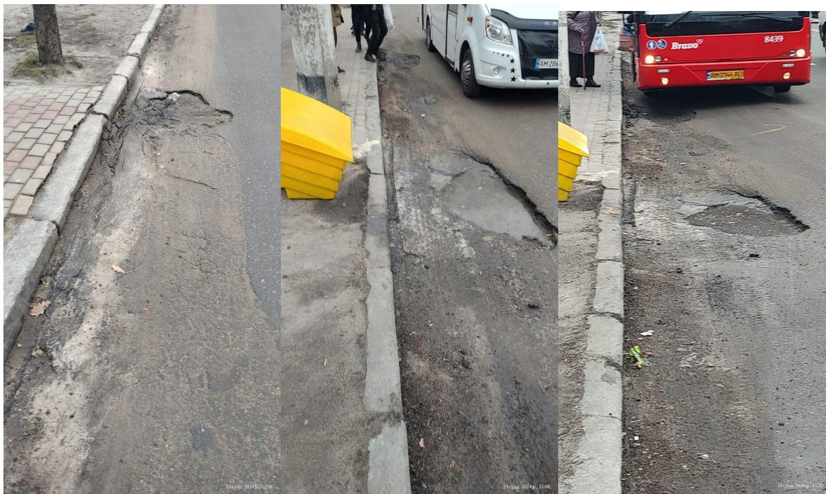
Рис. 1. Пошкоджене асфальтобетонне покриття на зупинках громадського транспорту.
