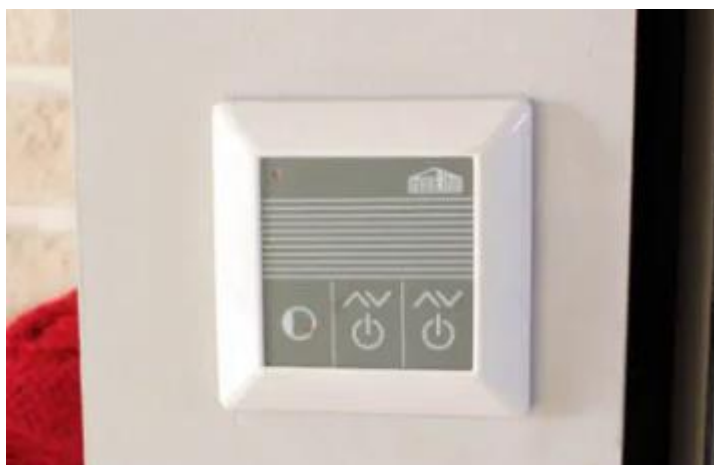
Рисунок 1.9 – Вигляд блоку контролю за освітленням [9]
