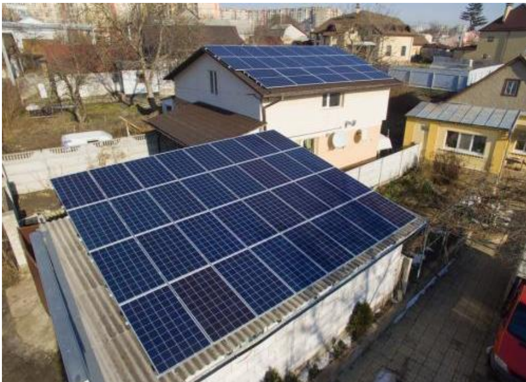
Рис 3.3. Мережева сонячна електростанція потужністю 15 кВт м.
