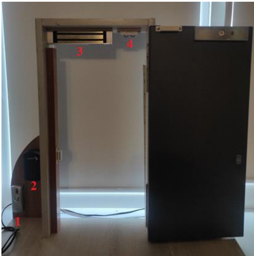
Рис.3.2 - Загальний вигляд розробленого макету стенду комплексу системи контролю і управління доступом (з відкритими дверима)
