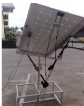
Рисунок 2.11 - Сонячна установка University Malaysia Sarawak
