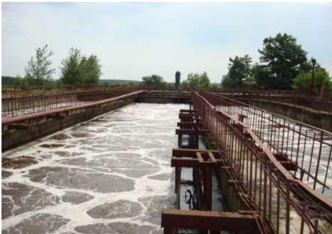
Рис. 3.4 Очисні споруди Коростенського КП «Водоканал»
